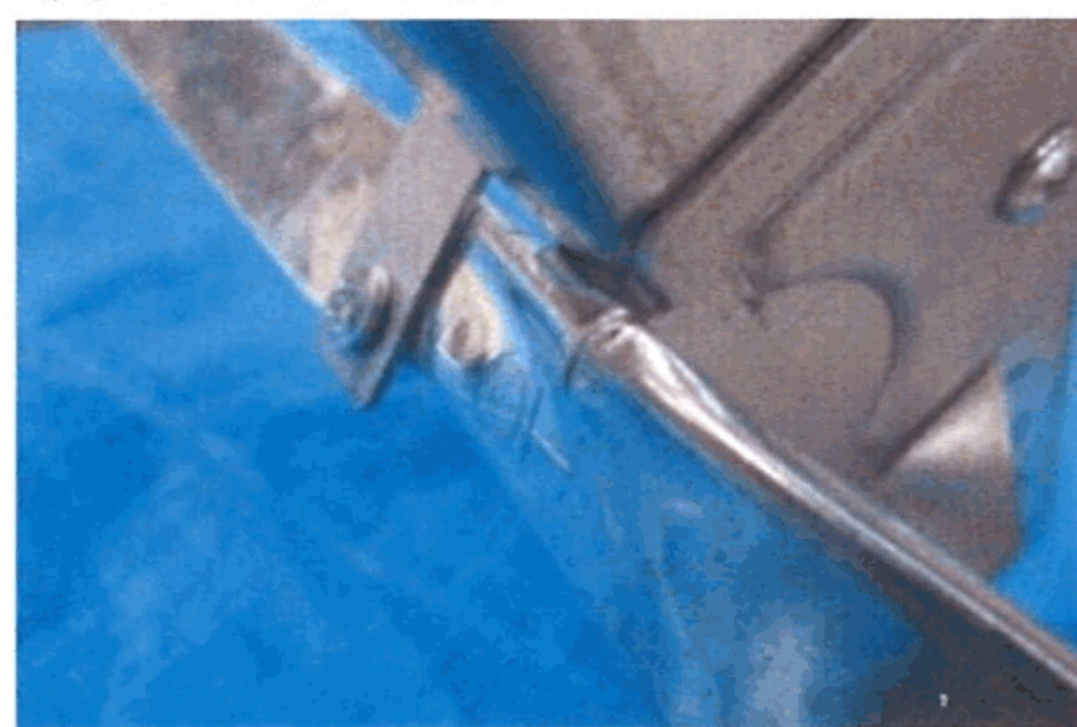
(f) 試験終了後 (野縁損傷部) 【No.2】
