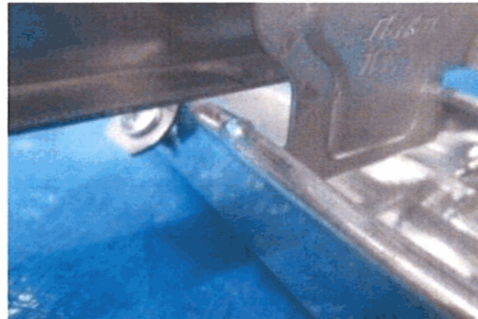
(l) 試験終了後 (野縁損傷部) 【No.2】
