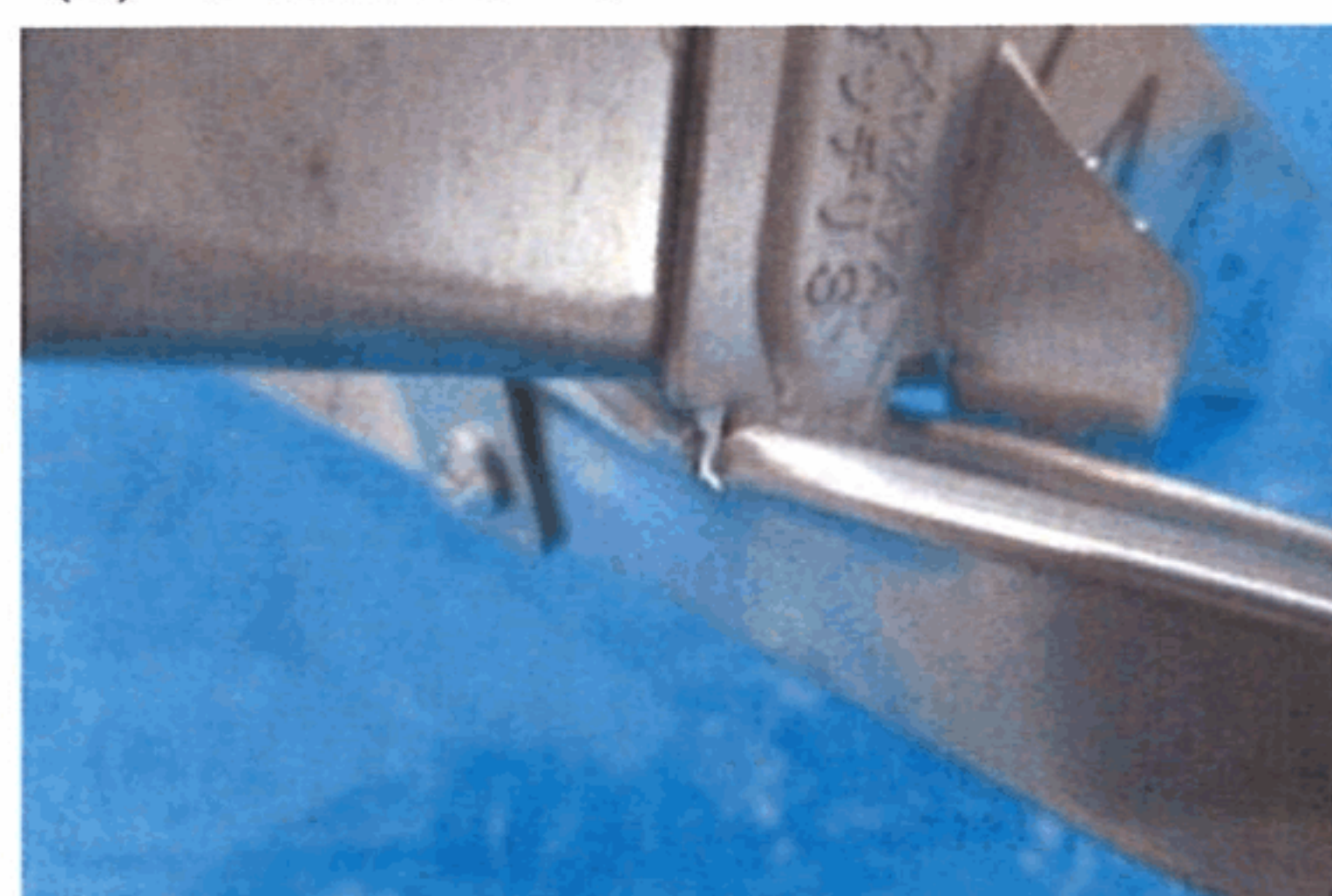
(c) 試験終了後（野縁損傷部） 【No.1】
