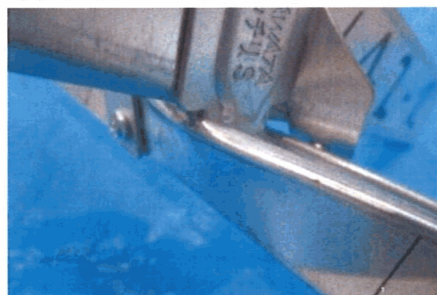
(f) 試験終了後（野縁損傷部） 【No.2】
