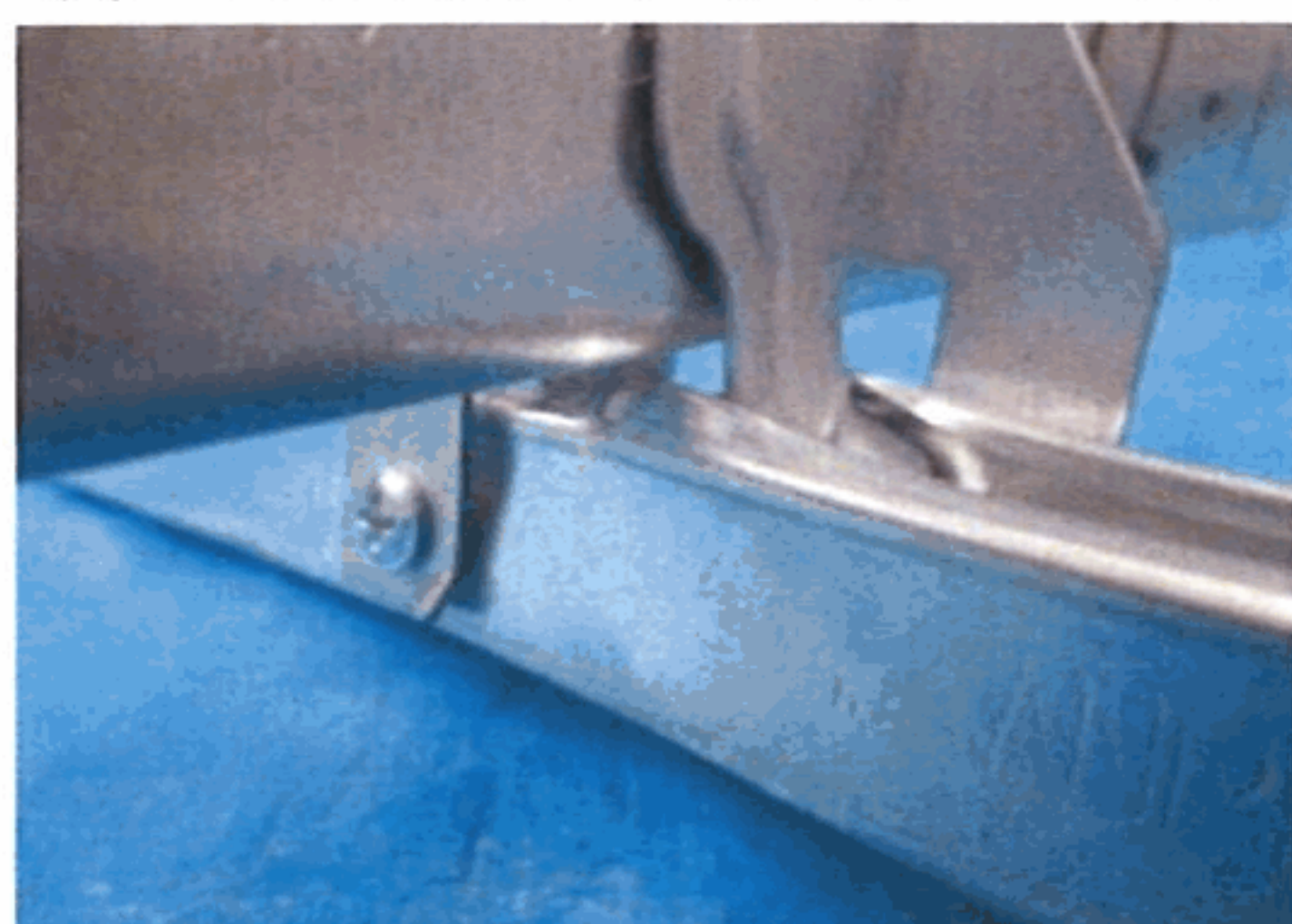
(f) 試験終了後 (野縁損傷部) 【No.1】
