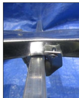
(d) 破壊の状態B (負側)
