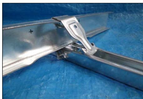
(b) 破壊の状態A（負側）,破壊の状態B
