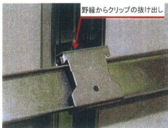
写真-10 試験後の状況（室外側，天井裏側）
